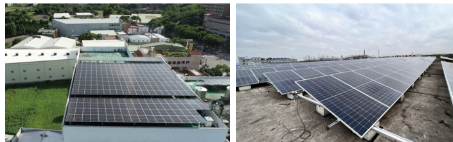
太陽能光電設備 台灣尖點 (左圖) 及上海尖點 (右圖, 建設中)
