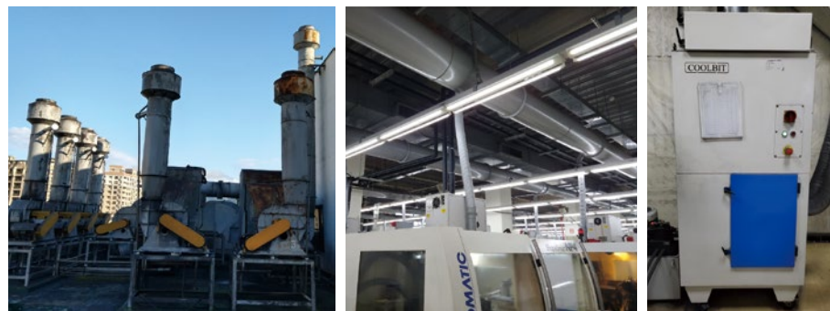
局部排氣裝置、靜電集塵裝置、濾網集塵裝置
